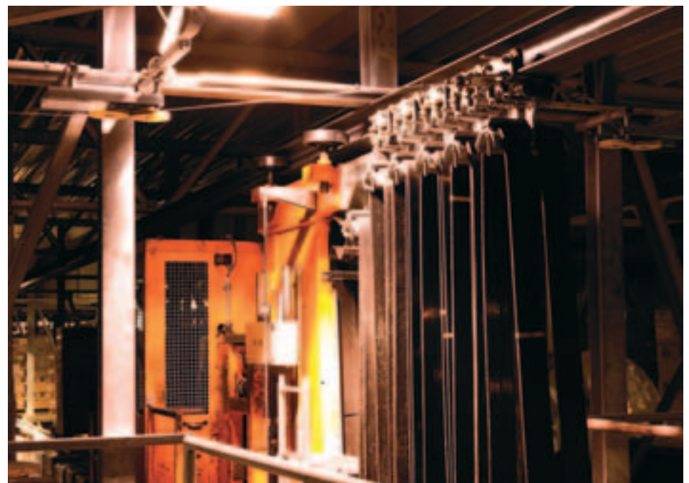
Abb. 2: 1988 war die Kabelschleppanlage an der Decke angebracht.
