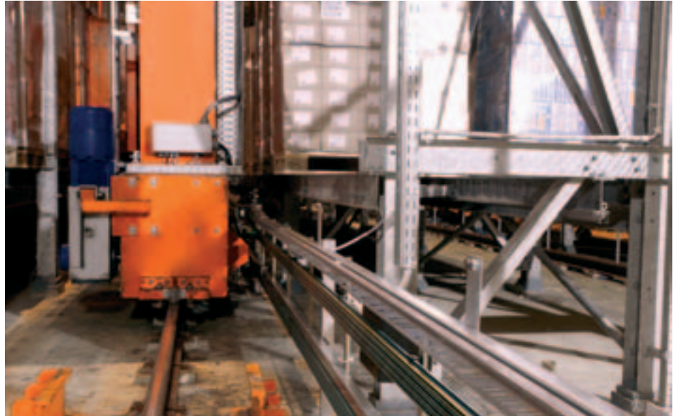
Abb. 3: Heutzutage wird die Schleifleitung unterhalb der Y-Achse (Y1) angeordnet, außerdem ist eine zweite Schleifleitung für Sprechfunkverbindung zur Kabine kundenspezifisch angebaut.
