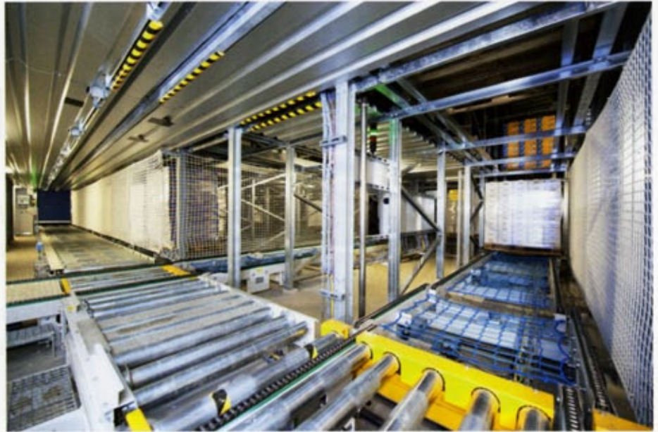
Fördertechnik innerhalb des Kanallagers
