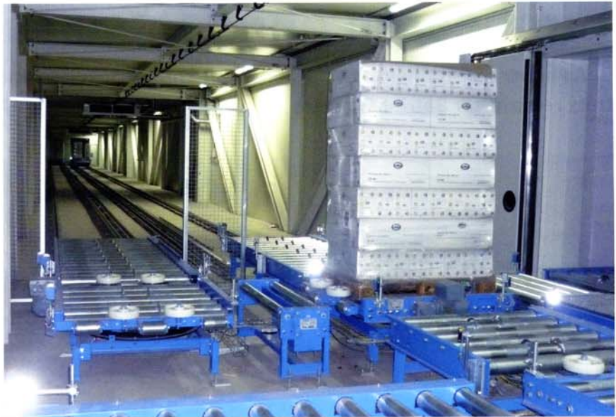
Keine Unterbrechung der Kühlkette: Eine temperaturgeführte Brücke verbindet bei Coppenrath & Wiese die Produktion mit dem Hochregallager.
